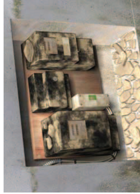
Dégradation d'un coffret de branchement extérieur. Crédit photo
