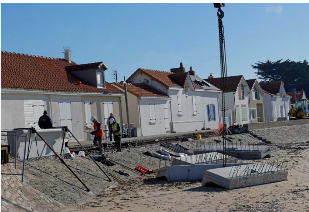
Travaux de défense contre la mer : mise en place du nouveau mur chasse-mer boulevard de l'océan
